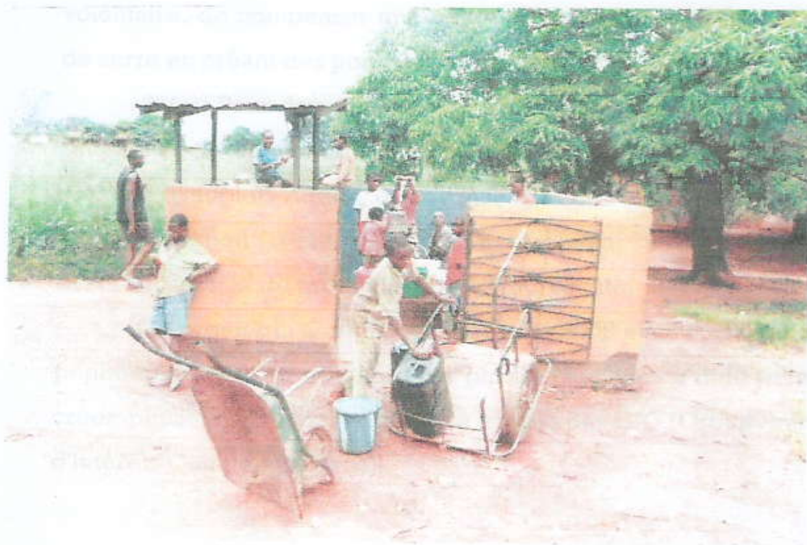
Puits aménagé par la Commune de DIMAKO
